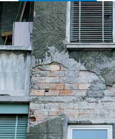
Poškozená fasáda domu, vyžadující opravu
